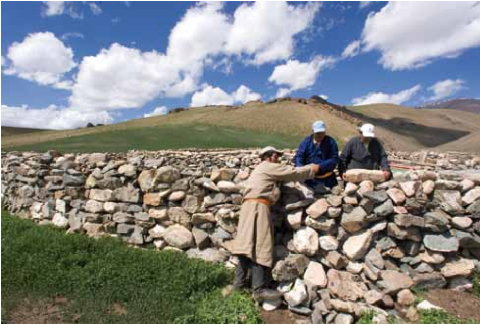
Das Aufschichten von Steinmauern ist ein wichtiger Teil eines Programms zur Verhinderung weiterer Bodenerosion in der Mongolei. Mit der Förderung solcher Vorhaben trägt das UN-Entwicklungsprogramm UNDP dazu bei, dass in Zeiten vermehrter Dürren und heftigerer Stürme die Viehzucht in Steppegebieten möglich bleibt. Foto: UN Photo/Eskinder Debebe
